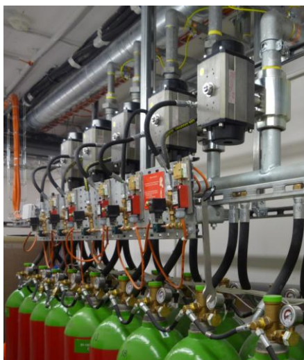
Sestava lahví systému Argonite C60 s rozvodnou deskou a sekčními ventily pro víceúsekový systém
